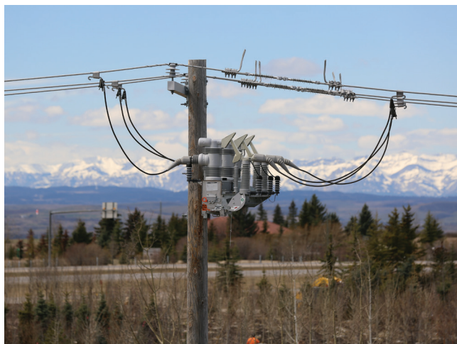
Figura 1. Um dos Interruptores de Falta IntelliRupter® PulseCloser® da S&C instalados pela ENMAX para tratar das interrupções momentâneas.
